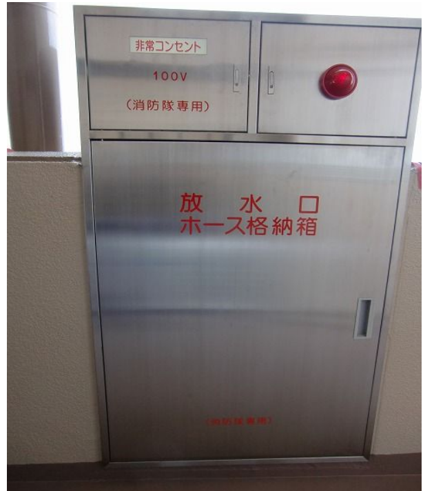
消防隊専用放水口ボックス
