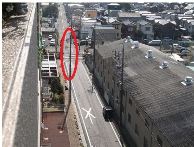
玄関側引き込み柱
